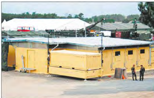
Мобильная дизель-солнечная электростанция в полевом лагере на территории Мали (лагерь Кэмп-Кастор близ г. Гао). Комплект сооружений рассчитан на размещение 1 000 военнослужащих бундесвера
